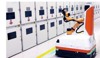
高電圧配電盤の操作
